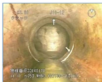
既設管渠の状況(カメラ調査結果)
