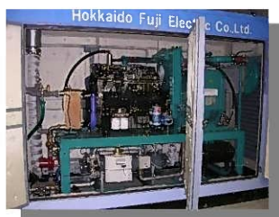
ガス発電機内部
