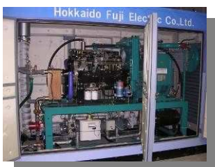
ガス発電機内部
