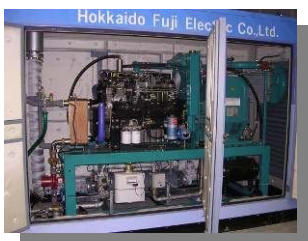
ガス発電機内部
