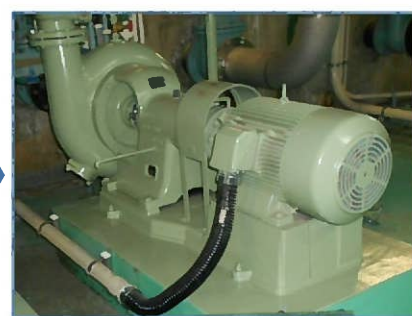
汚水ポンプ (改築後)
