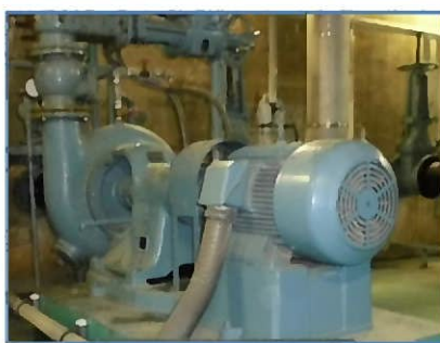
汚水ポンプ (改築前)
