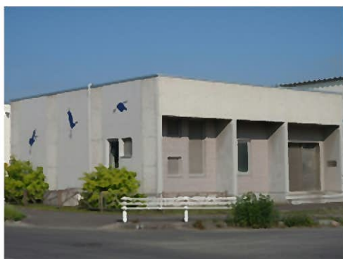
明野中継ポンプ場
