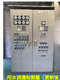
用水現場制御盤 (更新後)
