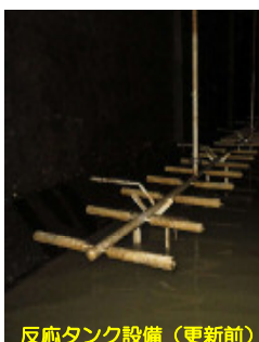
反応タンク設備 (更新前)
