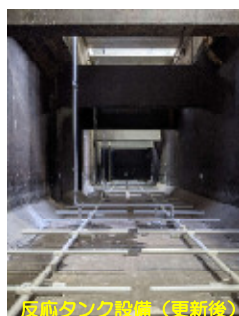
反応タンク設備 (更新後)
