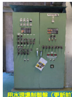
用水現場制御盤 (更新前)
