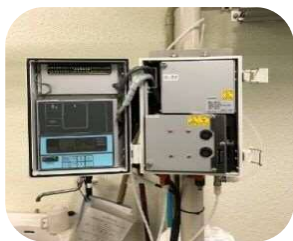
水道水自動測定装置
