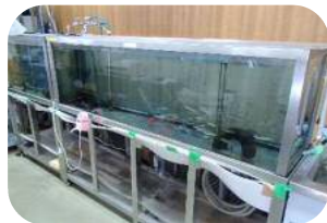
バイオアッセイ装置 水質の変化に敏感な魚類（ヤマメ）で、水質の変化を常時監視します。
