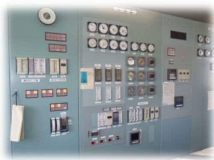
老朽化した中央監視室（高丘浄水場）
