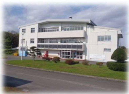
老朽化が進む高丘浄水場管理棟
