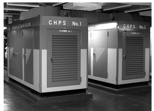
ガス発電設備外観
