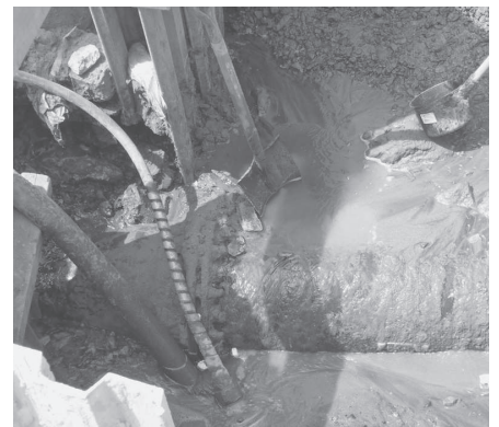
破損して漏水した水道管 この状態では安定した水の供給はできません
