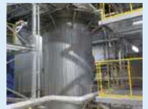
⑥ 排ガス減温塔 排ガスの温度を冷やすため、水をふきかけます。
