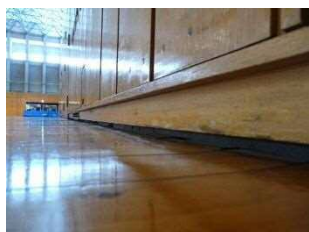
総合体育館床の沈下
