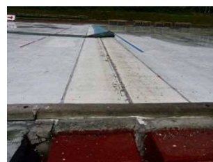
ハイランドスポーツセンター 屋外スケートリンクの劣化
