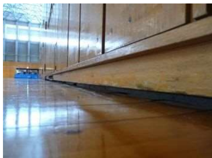
総合体育館 床の沈下
