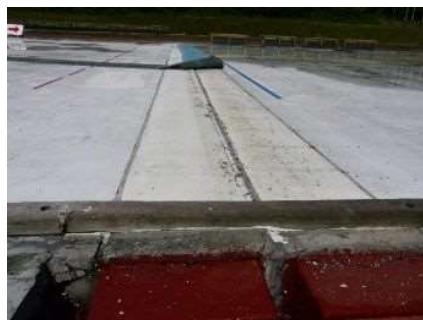
ハイランドスポーツセンター 屋外スケートリンクの劣化
