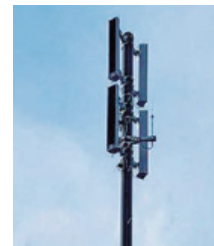
市内全域に配備が完了 した防災行政無線
