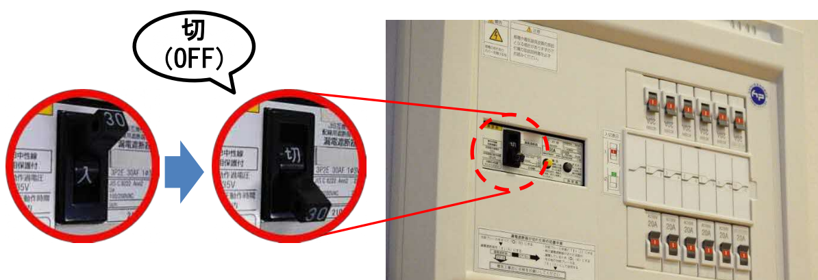
避難する際は分電盤のブレーカーを切る
