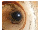
煙突断熱材 (アモサイト含有)
