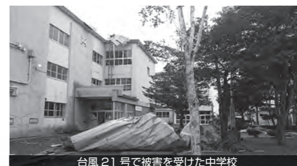
台風21号で被害を受けた中学校
