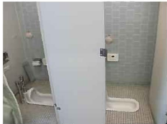
トイレ内には手すりが設置されていない
