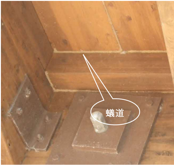
写真 2.2.5 しろありの蟻道の事例
