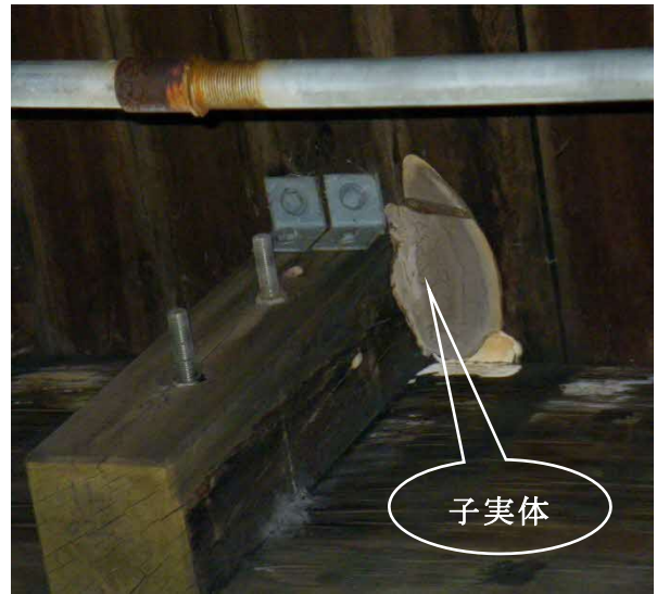
写真 2.2.6 木材腐朽菌の子実体の事例
