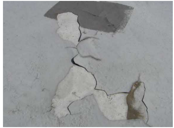
写真 2.1.2 防水層の破損の事例
