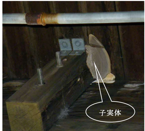
写真 2.2.6 木材腐朽菌の子実体の事例
