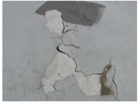
写真 2.1.2 防水層の破損の事例
