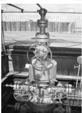
苦小牧CCS-1号坑口装置（H23（2011）年2月）
